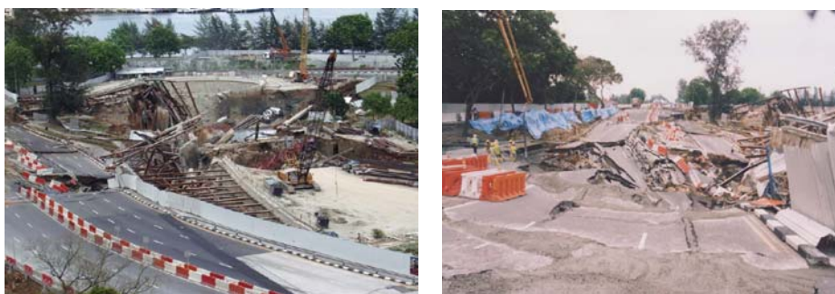
图 29.44 新加坡基坑坍塌照片
