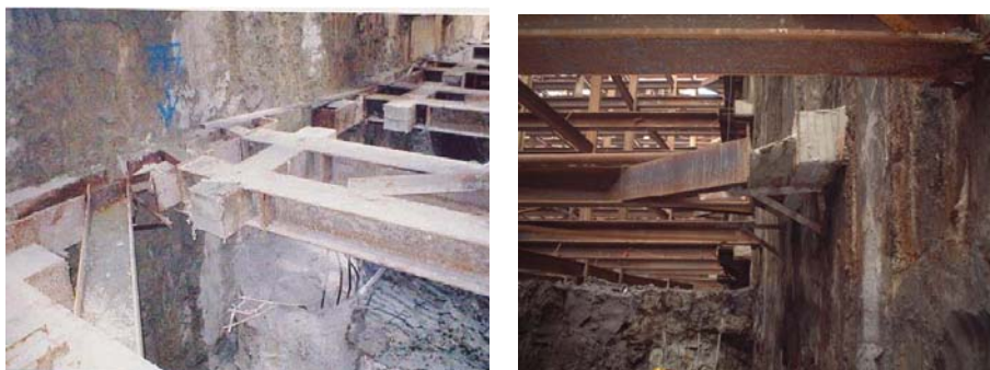
图 29.45 发生破坏前的第九道钢支撑
